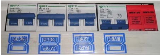
图4 混乱的家庭空气开关 Fig.4 Chaotic home air switch
